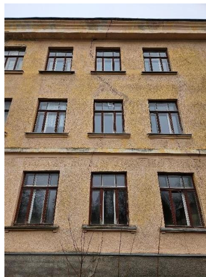
Ēkas fasāde ar plaisu
